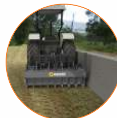
Mejor compactación en los bordes
